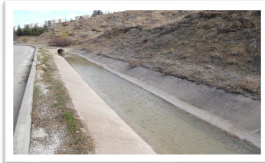
Resim.4.2.a. Su Geri Dönüşüm Programı Kapsamında Yağmur Kanalları
