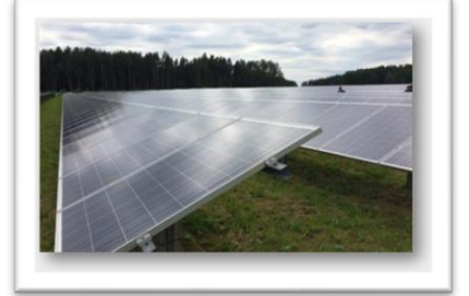
Resim.2.4.1.f. Orman Alanındaki Güneş Panelleri
