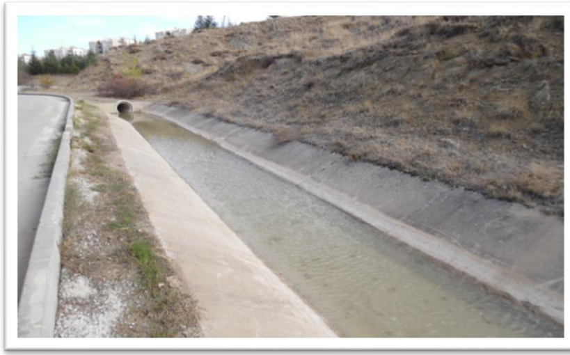
Resim.4.2.a. Su Geri Dönüşüm Programı Kapsamında Yağmur Kanalları
